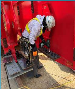
④下フランジボルト接
